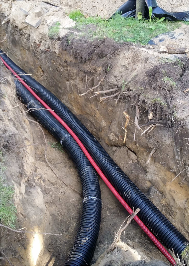
22. Šiluminė trasa ties išsišakojimu. Vaizdas iš ŠR.
