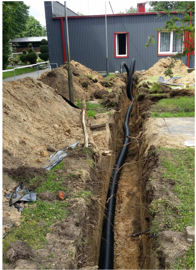
19. Šiluminė trasa į gydyklos pastatą. Vaizdas iš PR.
