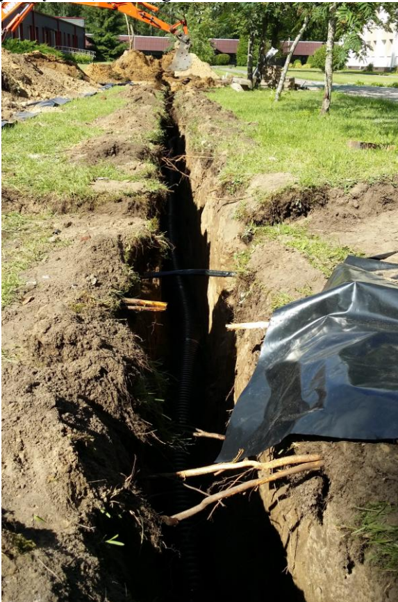
3. Šiluminė trasa iš PV
