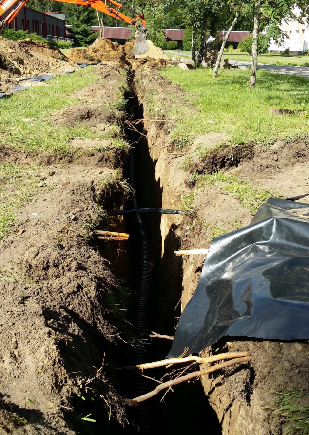
18. Kasama šiluminė trasa nuo saulės kolektorių. Vaizdas iš PV.
